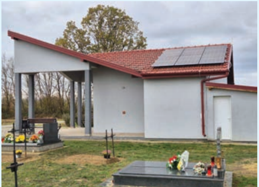
Na mrtvačnici u Čamagajevcima postavljeni su solarni paneli
